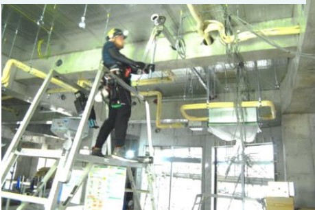
【1階 天井内給排水衛生配管】
